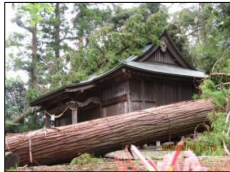
皆吉・熊野神社台風被害
