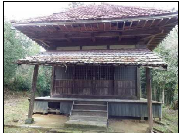
長善寺の本堂の建物。痛みが多く見られる
